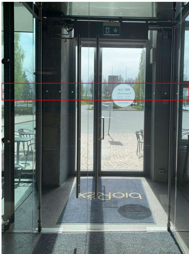
KUVA 33. Lasisen tuulikaapin puutteelliset turvamerkinnyt rajattuna suorakaidella.
