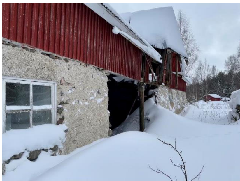
KUVA 25. Kivimuriin tehty aukko. (Henriksson, J. 2022)
