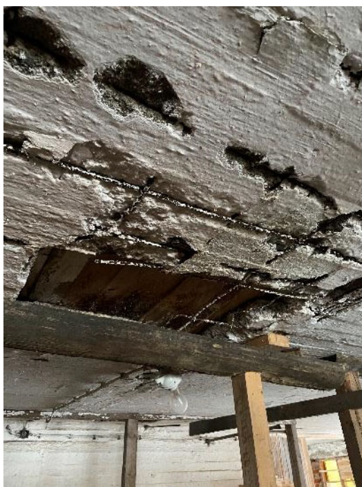
KUVA 27. Navettatilassa painunut välipohjarakenne. (Henriksson, J. 2022)
