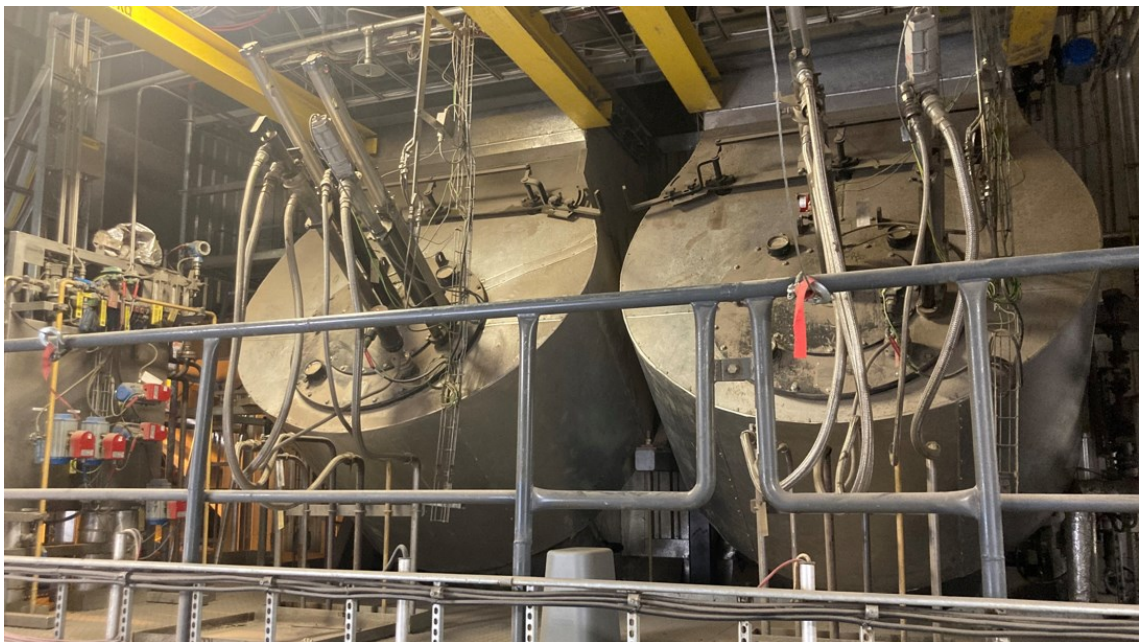
Kuva 5. Kaksi sivuseinän käynnistyspoltinta.
