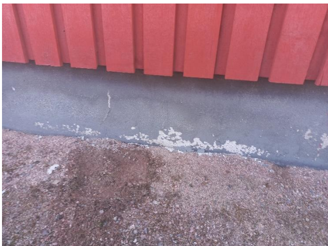
Kuva 2. Kuntoarviossa havaittu vaurio rakenteessa.
