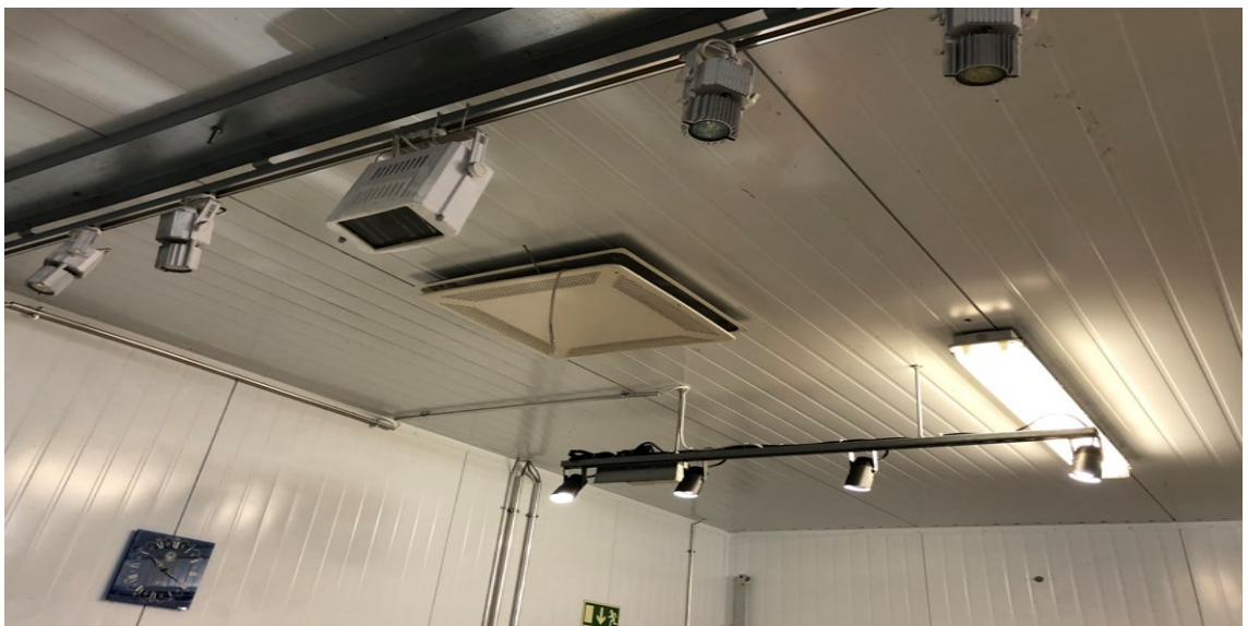
KUVA 8. Uuden valot taempana ilmastointi venttiilin takana.
