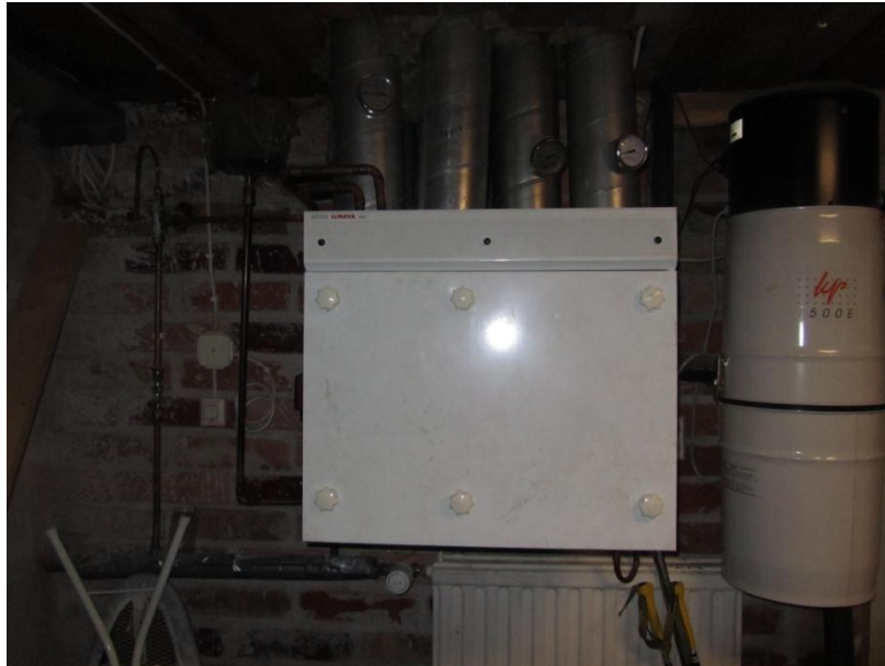
KUVA 4. Ilmanvaihtokone MUH ILMAVA VKL
