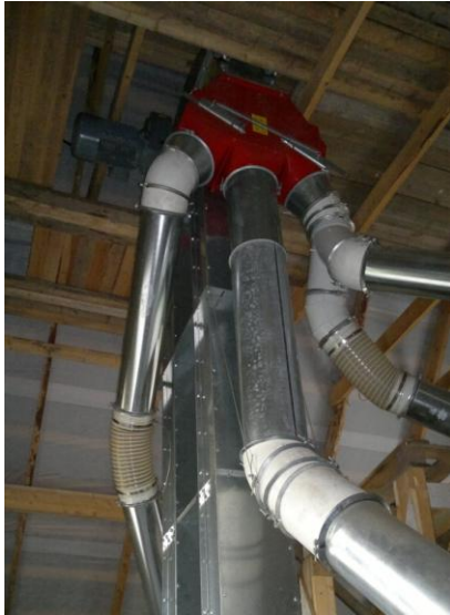
Kuva 5. Elevaattorin yläosa, jossa mekaaninen kolmitiejakaja
