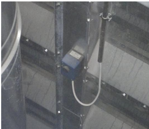
Kuva 44. Poistoilmaputken lämpötilaa vahtiva palotermostaatti
