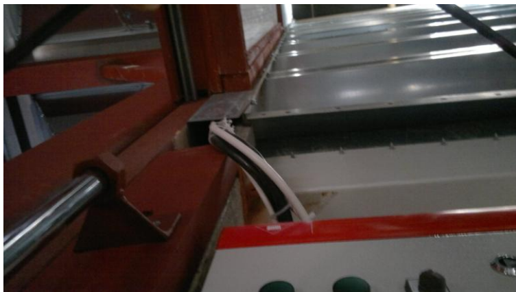
Kuva 27. Ylätasanteen laitteiden kaapelit nousevat seinän nurkkakotelossa
