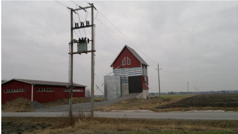
Kuva 21. Jakelumuuntaja, josta maatilän sähkönsyöttö tulee maakaapelilla
