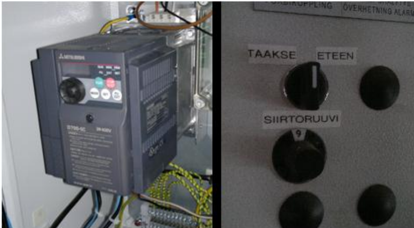
Kuva 31. Kaatoaltaan ruuvia ohjaava taajuusmuuttaja
