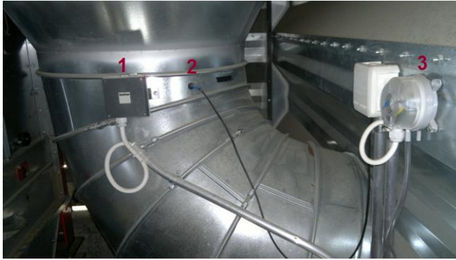
Kuva 43. Tulopuolella sijaitsevat LTM-termostaatti (1), PTC-anturi (2) sekä paine-eron mittari (3)
