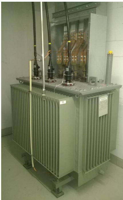
Kuva 7. Kosketussuojattu kaapelipääte muuntajan kannella
