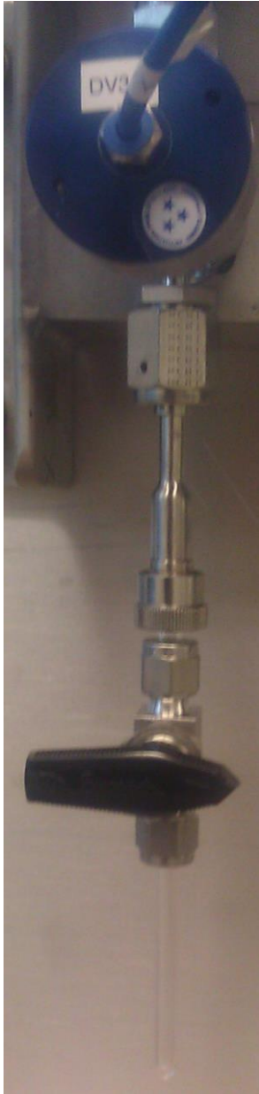
Kuva 8. Kaasulinjaan vietävä näyte kiinnitetty ultratorr-liittimeen venttiilissä DV314 (Liite 2, PI-kaavio).
