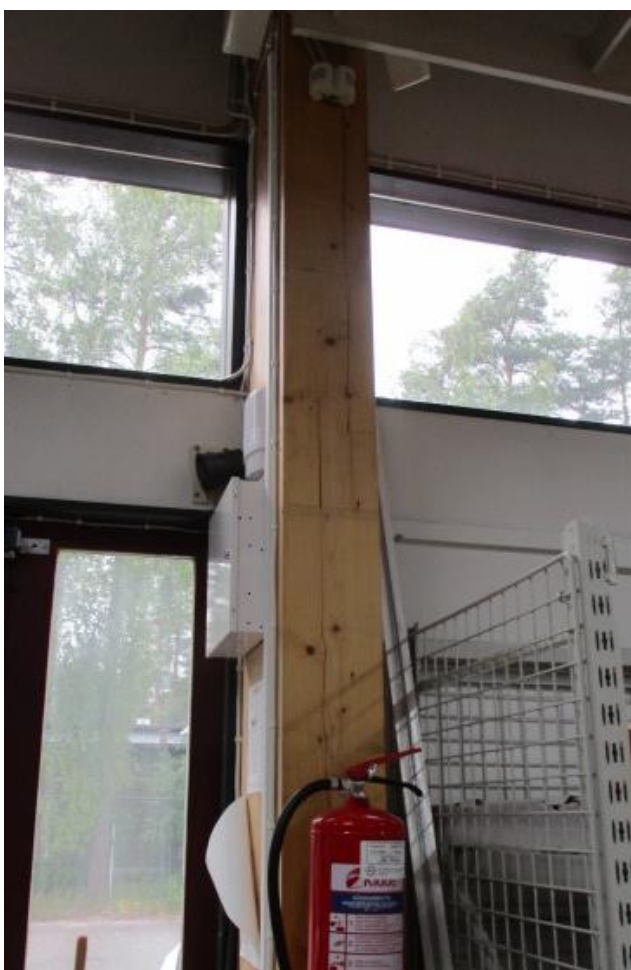
Kuva 43. Pilarin halkeamia (Heli Rautiainen 2022).
