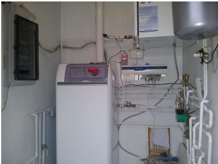
Kuva 9. GVR140 kattila ja lämmityskeskus.
