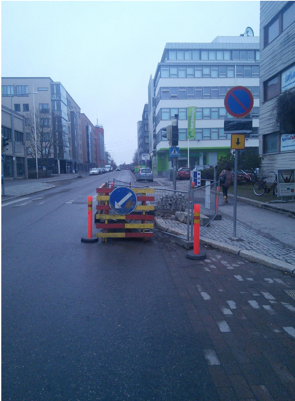
Kuva 9. Kaivutyömaan suojaus- ja ohjauslaitteissa on toivomisen varaa. Materiaalien tulee heijastaa valoa ja erottua ympäristöstään selkeästi (Miikka Sireni, Helsingin kaupunki).
