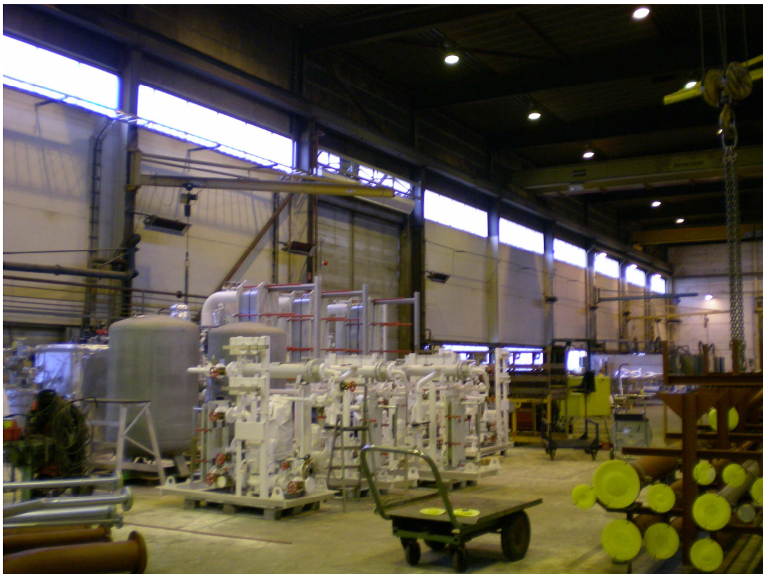
Kuva 2.2 Tehdashallin seinillä sijaitsevat nestekaasusäteilijät
