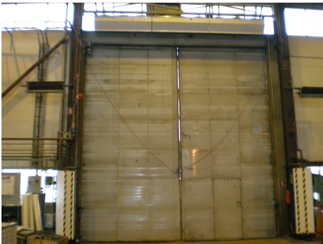
Kuva 4.7 Tehdashallin eteläpäädyssä sijaitseva ilmaverho
