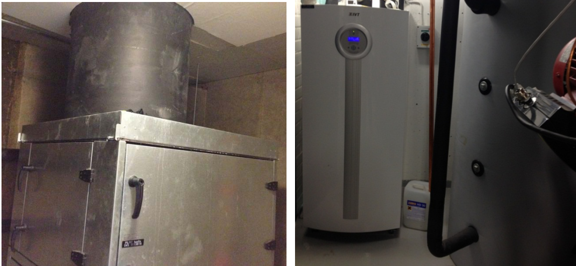
Kuva 36. Vasemmalla talteenotto-kammio, oikealla lämmönjakohuone, Armas Launiksen katu 7. [33]
