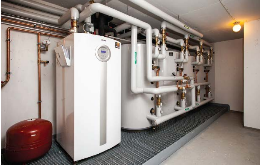
Kuva 45. Senera: Kohteen lämmönjakohuone. [41]
