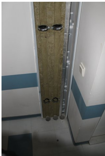
Kuva 64. Avattu kotelo porraskäytävässä, putket ei paikalla.[40]
