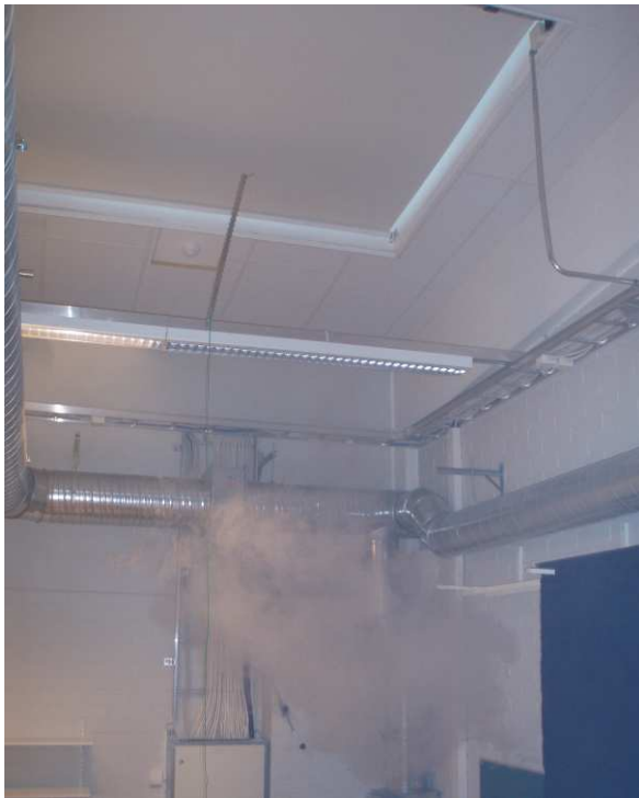
Kuva 14. Kattoikkunan aiheuttama konvektio- ja/tai vuotoilmavirta.
