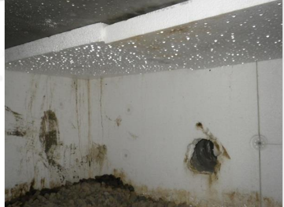
Kuva 20. huoneiston G 40 päädyssä olevan tuuletusaukon yläpuolella on runsaasti kondenssivettä.
