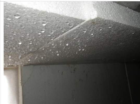
Kuva 17. Ryömintätilan puolella tarkastusaukon yläpuolella on kondenssivettä eristelevyn pinnalla.
