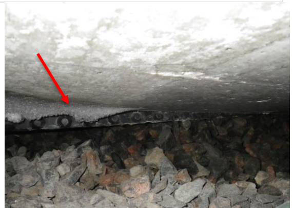
Kuva 24. Sokkelin ja patolevyn välissä näkyy jäätä.
