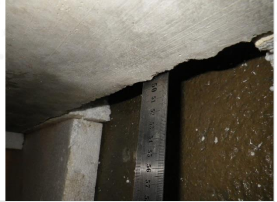
Kuva 34. RT3: Höyrynsulkumuovi on noin 500 mm ontelolaatan alapintaa korkeammalla.
