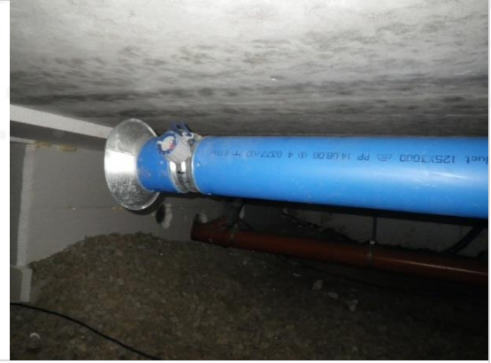
Kuva 26. Huoneiston G39 alapuolella oleva koneellisen ilmanpoiston pääte-elin.
