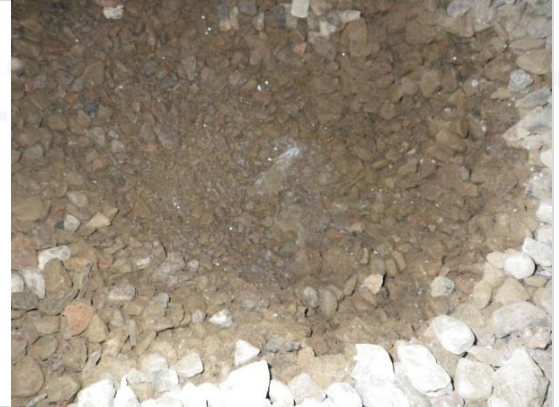
Kuva 41. Sepelikerroksen alaosa on märkää ja sen seassa on runsaasti hienoa ainesta.
