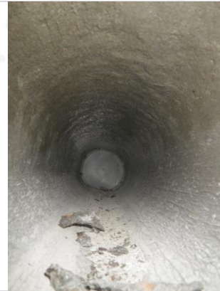
Kuva 46. Ontelon sisäpinta rakennuksen päätyseinää kohti. Yläpinta on märkä.
