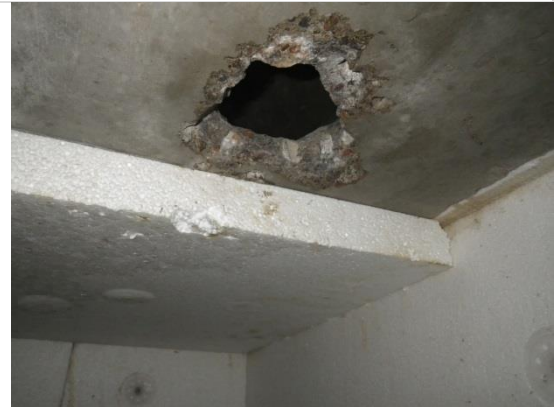
Kuva 48. Ontelolaatan avauskohta huoneiston G40 ruokatilán alapuolella. Lähempänä RT2:ta..
