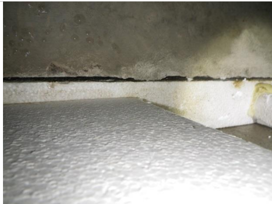
Kuva 29. RT3: sokkelin EPS-eristelevyn ja ontelolaatan välissä on noin 5 mm:n ilmarako.
