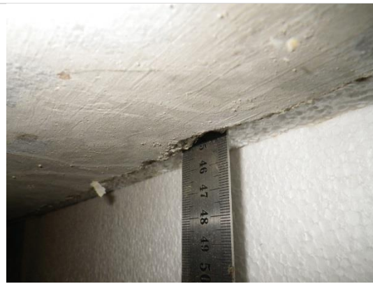
Kuva 39. Huoneiston G 37 kohdalla mitta osui myös alapohjan ylempään lämmöneristelevyyn.
