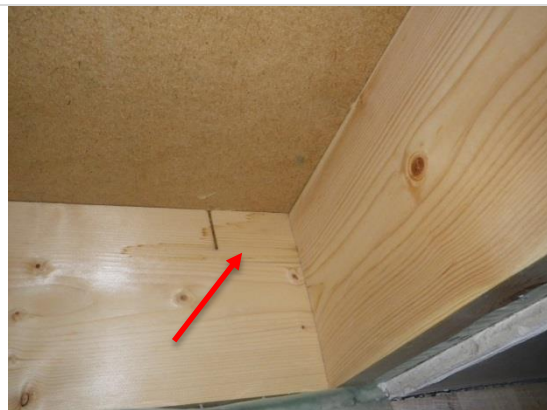
Kuva 3. RT1: rungossa ja tuulensuojalevyssä näkyy kosteusjälki.
