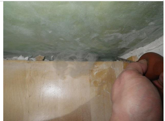
Kuva 12. RT1: ilmavuoto ulkoseinän ja tuulikaapin väliseinän liittymässä ruokatilan oikeassa alanurkassa.
