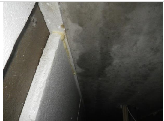
Kuva 50. Laatan alapinnassa näkyy ontelon sijainti kosteana pintana.
