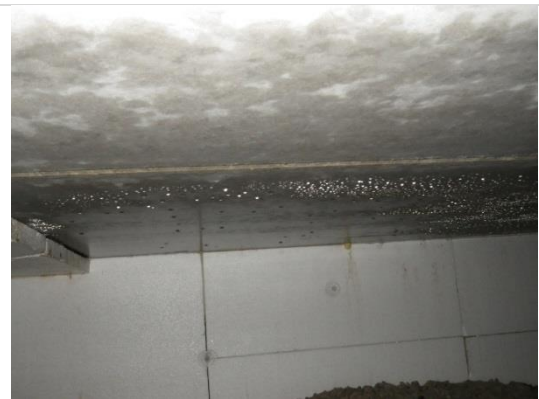
Kuva 18. Aukon vieressä olevan tuuletusaukon yläpuolisilla pinnoilla on runsaasti kondenssivettä.
