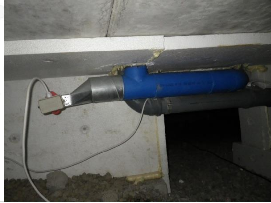
Kuva 25. Huoneiston G34 alapuolella oleva koneellisen ilmanpoiston pääte-elin.
