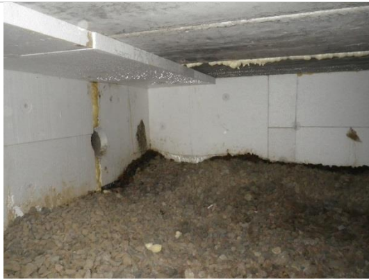
Kuva 21. Huoneiston G 40 ruokatilän alapuolella sijaitseva ulkonurkka, jonka pinnoilla on runsaasti kondenssia.
