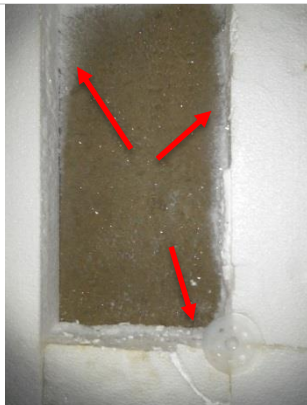
Kuva 23. Lämmöneristeen saumoissa ja takana sokkelin pinnassa on jäähileitä.
