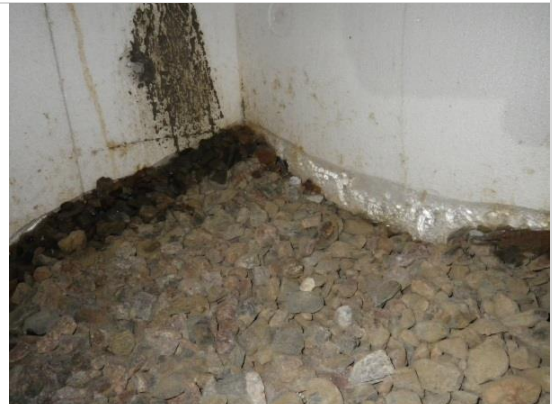
Kuva 22. Sepelin seasta nouseva kosteus on jäänyt sokkelin alaosaan tuuletusaukon lähellä.
