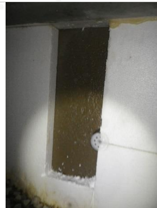
Kuva 28. RT3: sokkelin pinta avauskohdan alapuolella oli märkä.
