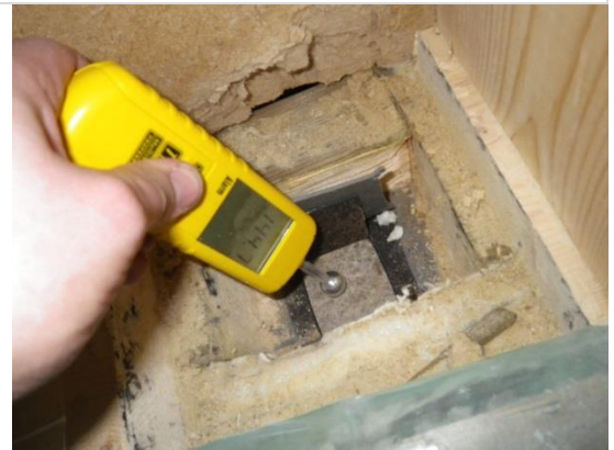
Kuva 10. RT1: sokkelin yläpinta oli pintakosteudenosoittimella tutkittuna märkä.
