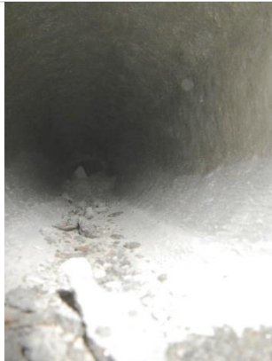
Kuva 47. Ontelon sisäpinta huoneistoa G39 kohti. Yläpinta on märkä.
