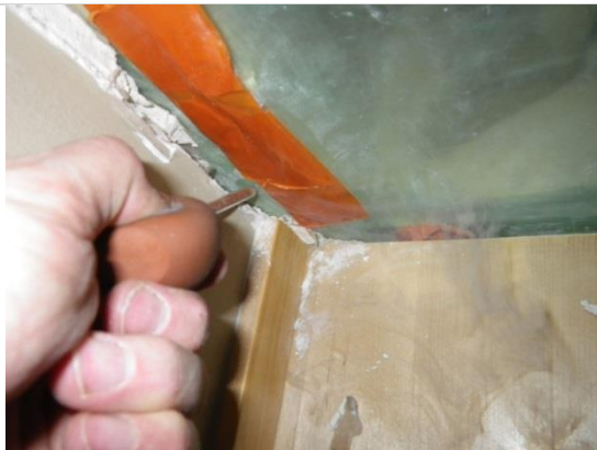
Kuva 11. RT1: ilmavuoto betoni- ja puulementtiseinién liittymässä ruokatilan vasemmassa alanurkassa.
