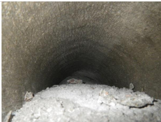
Kuva 49. Ontelon sisällä on massaa lattiavallusta. Osa ontelon sisäpinnasta on märkänä.
