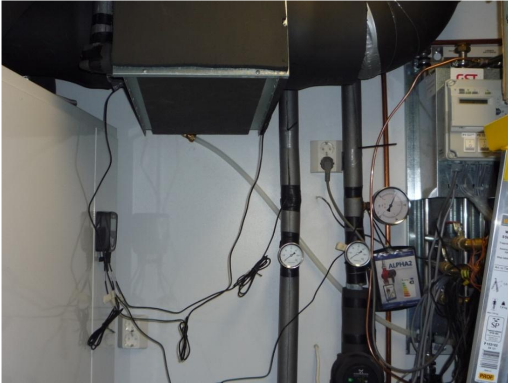
KUVA 5. Loggeri ja anturit asennettuna kohteessa H
