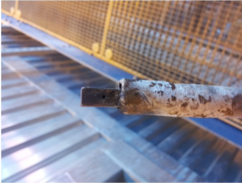
Kuva 14. Rikkoutunut ammoniakkin syöttösuutin
