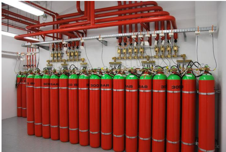
Kuva 8. Datakeskuksissa käytettävä kaasumainen palonestojärjestelmä. (Gas-Fire-Suppression.)
