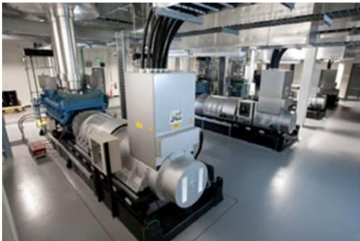
Kuva 7. Rotary UPS-laite Ciscon datakeskuksessa. (Cisco Allen Rotary UPS.)
