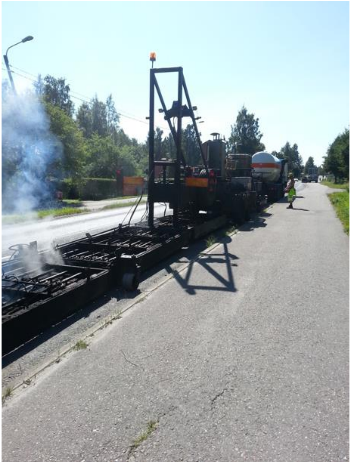
Kuva 5. Esilämmitin. Hinattava lämmityslaitte on vasemmalla ja säiliöauto takana oikealla.(Kuva Joonas Seppänen).
