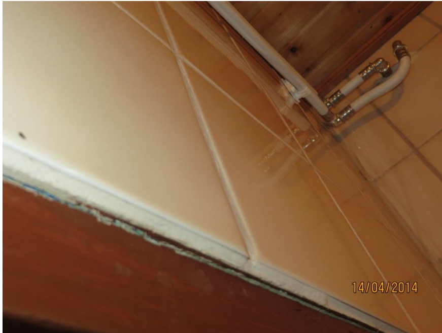
Kuva 34. Seinäläatoitus on irronnut saunanoven yläpuolelta. Kuvassa näkyvät myös uudet käyttövesiputket.
