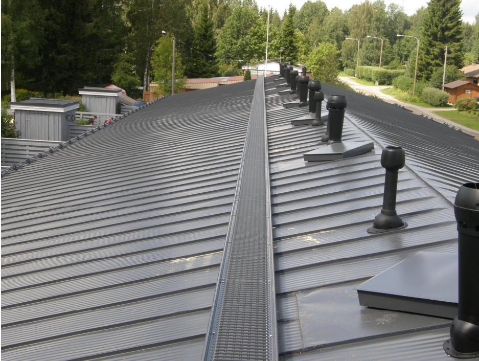
Kuva 14. Ullakkotilan tuuletus oli suunniteltu jokaisen osakkeen kohdalle.
