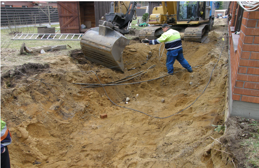
Kuva 3. Ongelman muodosti kiinteistön päävirtakaapelien sekä pienempien maakaapelien sijoitus.
