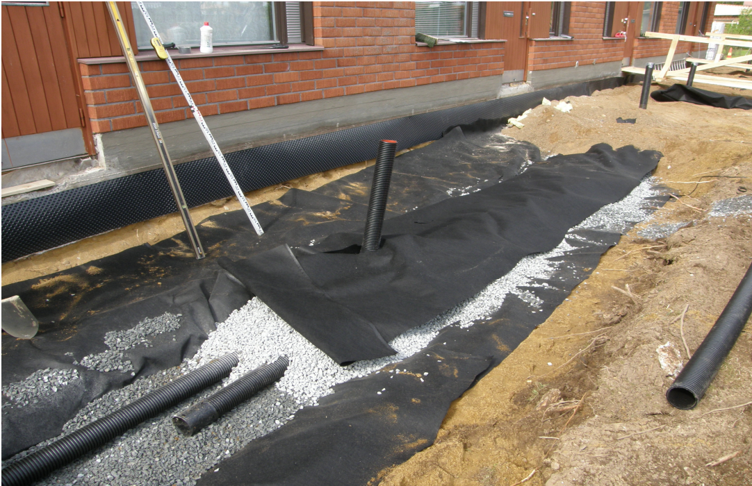
Kuva 6. Pintaan nostetut kattoviemäriveraukset rajoittavat maantiivistämistä, toisaalta anturavalut ja eristeet olivat lähes samassa asennussyvydessä.
