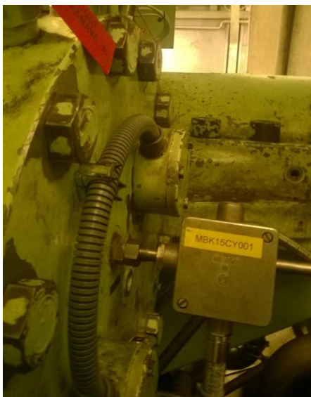
Kuva 30 Generaattorin akselin siirtymä
