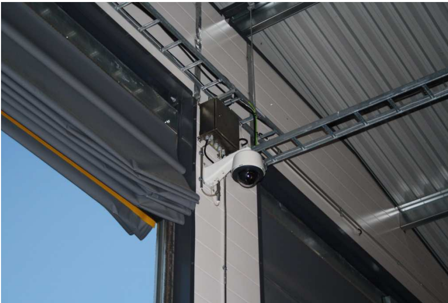
Kuva 4. Asennettu PZT-kamera ja kytkentäkaappi
