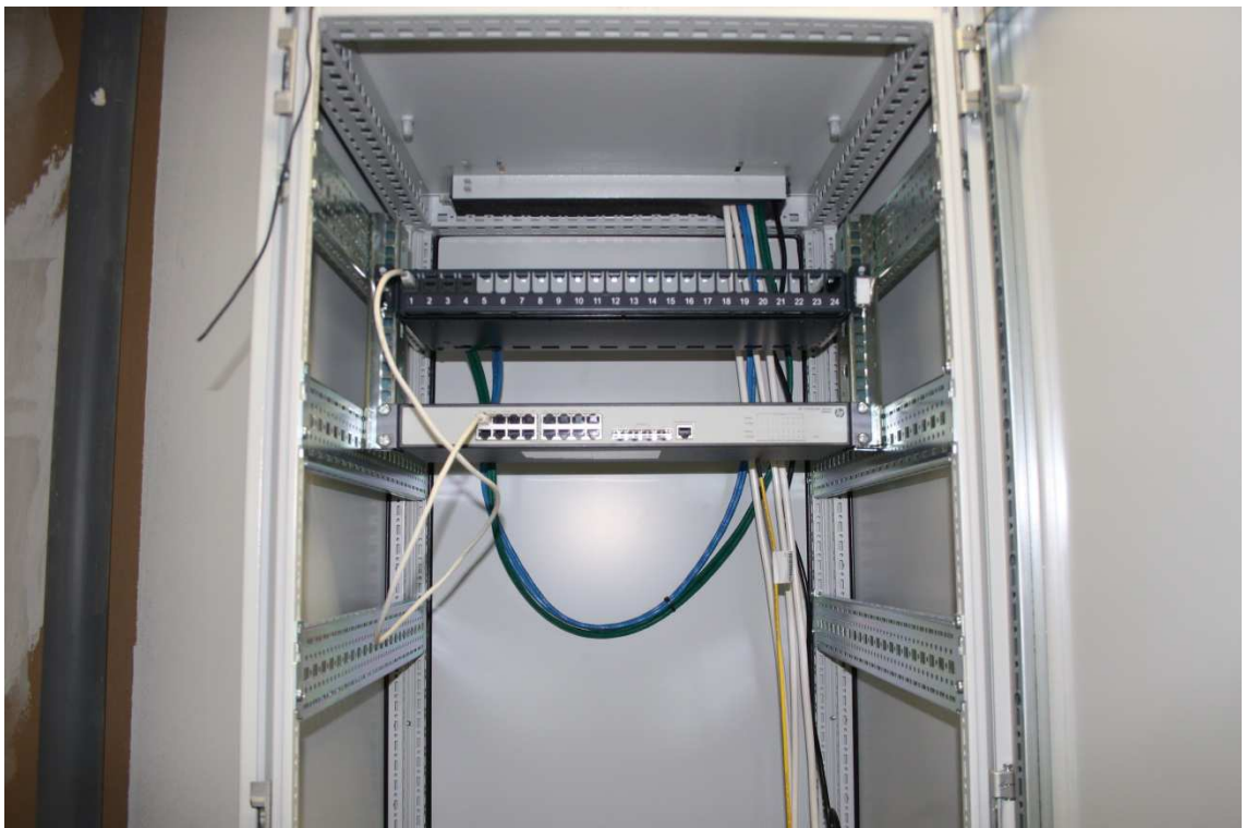
Kuva 7. Kameravalvonnan atk-kaappi, kytkentäpaneeli ja kytkin
