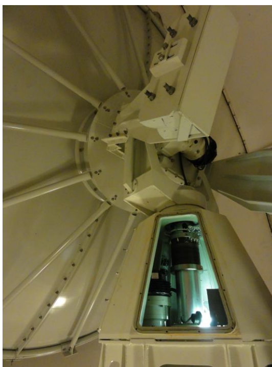
Kuva 6. Meteor 360 AC pedestaali ja antenni.
