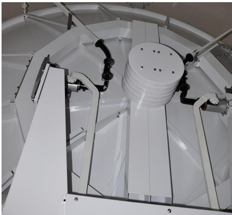
Kuva 8. WRM200 Pedestaali ja antenni.
