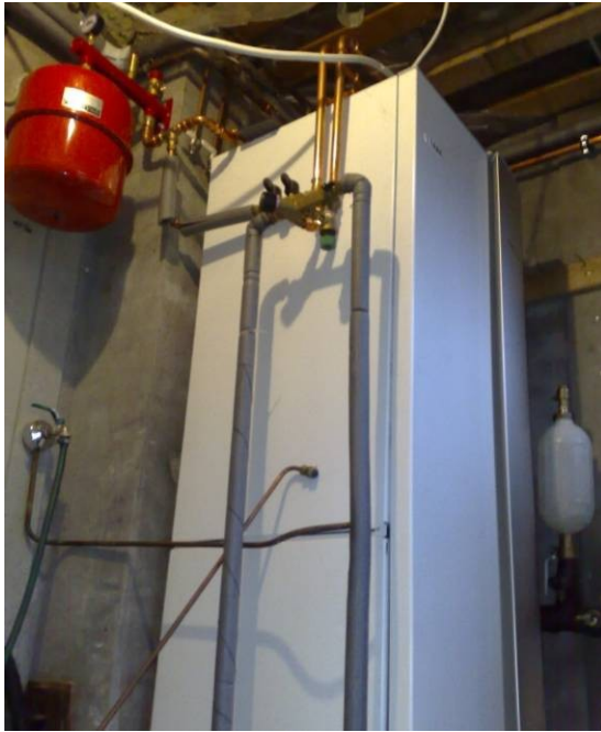
Kuva 13. Maalämpöpumppu Nibe Fighter 1240
