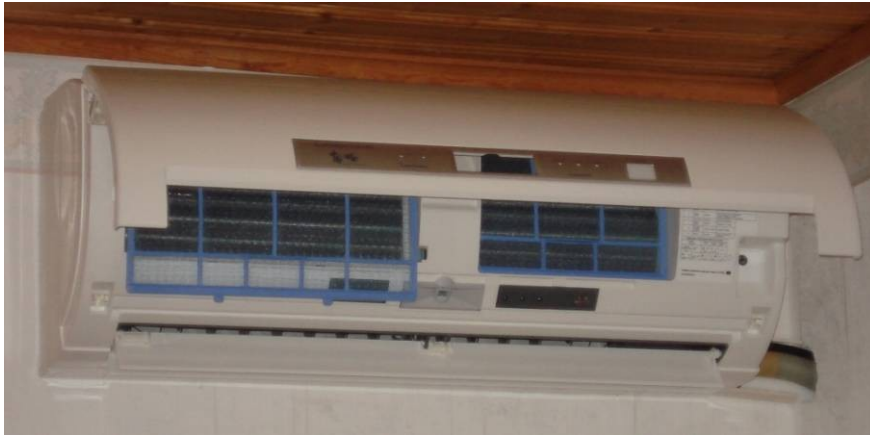
Kuva 11. Ilmalämpöpumpun sisäyksikkö malli Mitsubishi Electric GE 25
