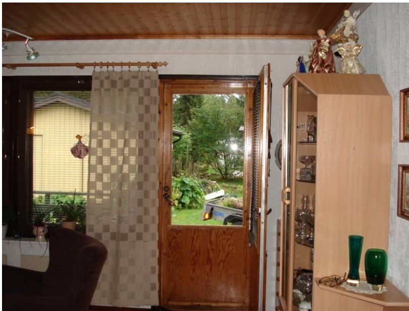
Kuva 39. Terassin oven päälle asennetun laitteiston ja katon väliin ei jää tarpeeksi tilaa
