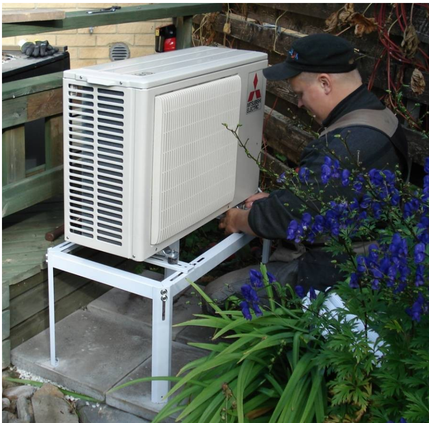
Kuva 12. Ilmalämpöpumpun ulkoyksikkö malli Mitsubishi Electric GE 25. Kuvassa asentaja Rami Sippala Suomen Energiansäästökeskuksesta.
