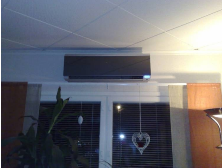
Kuva 32. Lg:n ilmalämpöpumppu esimerkikohteessa
