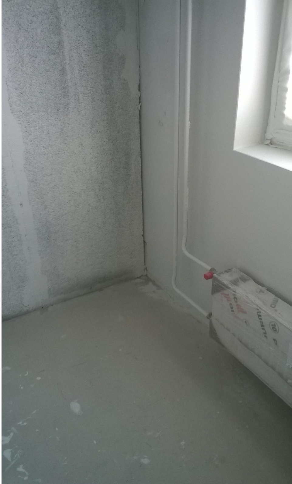
Kuva 20. Mittauksessa havaittiin ilmavuoto väliseinän ja ulkoseinän välissä. Korjausta varten väliseinää olisi pitänyt piikata pois alareunastaan. Korjaus toimenpiteet jätettiin toistaiseksi tekemättä, ja niiden tarve kartoitetaan myöhemmin uudelleen.
