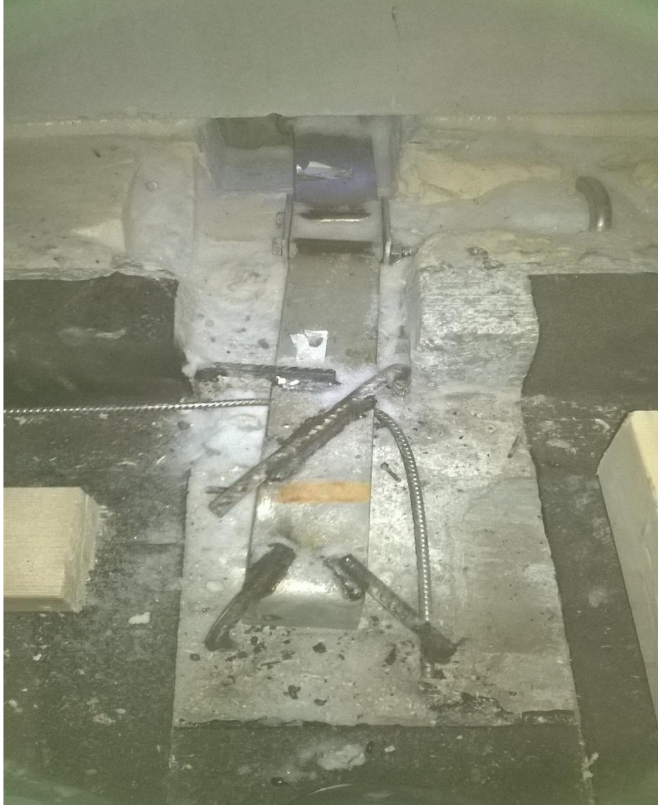
Kuva 11. Parveke”kenkä” ullakkotilasta kuvattuna. Kengän ja elementin liitosta ei ole eristetty.
