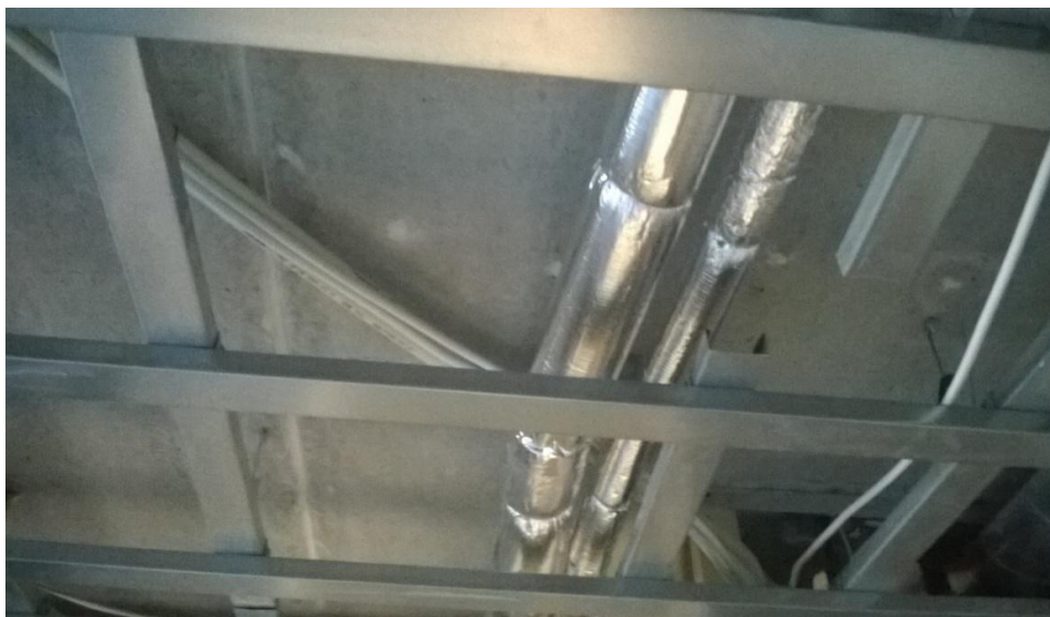
Kuva 18. Alakattojen päälle jäävät kittaukset. Kaikki onteloiden kuivattamista varten poratut reiät on tukittu akryylillä, samoin kuin ontelolaattojen sauma.
