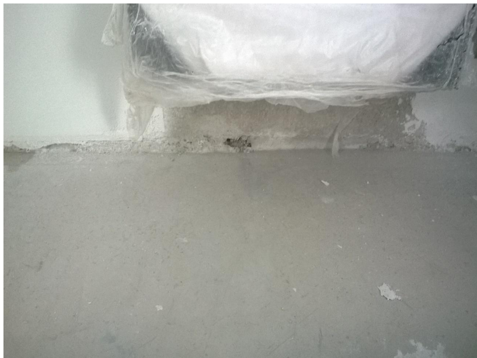
Kuva 19. Esimerkki ilmavuotokohdasta ensimmäisen kerroksen asunnossa. Seinän juurivalu on puutteellinen.
