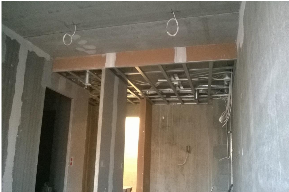
Kuva 17. Alakattorunko ja kipsiotsa mitattavassa asunnossa. Otsan sisäpuolella olevat vesireiät ja ontelolaattojen saumat kitattiin akryylillä joka asunnossa. Ulkopuolella olevat tiivistyvät maalarin tehdessä tasoite- ja maalaustöitä.
