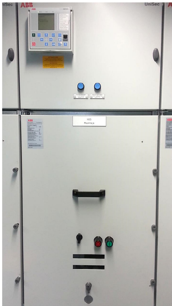
Kuva 14. 10 kV:n muuntajalähtö H05.
