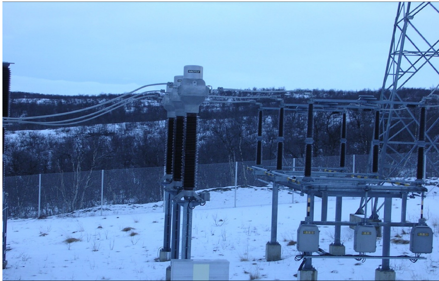
Kuva 7. Virtamuuntaja sähköasemalla (Paulava 2005, hakupäivä 9.4.2014)
