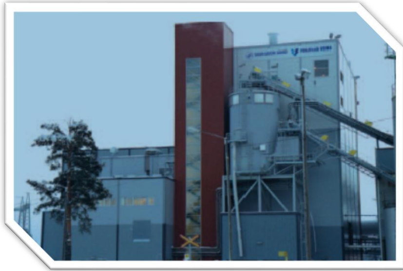
Figure 11 Savonlinna power plant ( http://www.pohjolanvoima.fi/filebank/165-4065-Savonlinnan_voimalaitos.pdf )
