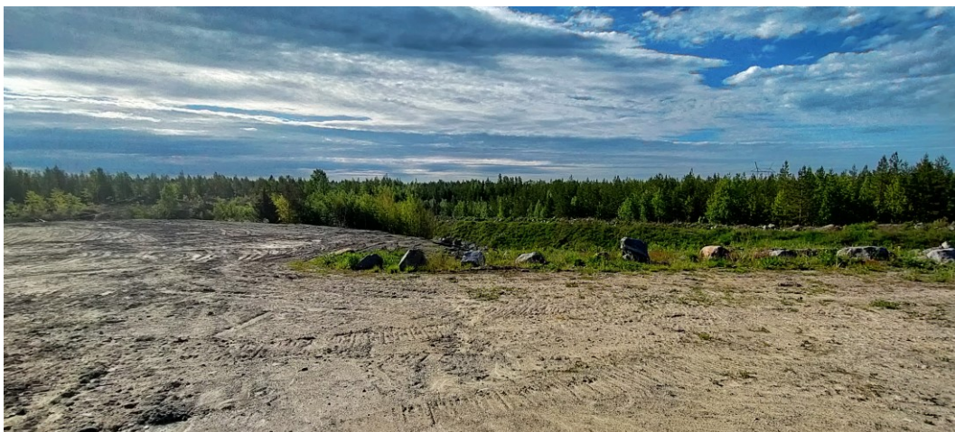
Kuva 15. Savimaita varten tarkoitettu allasrakenne. Myös taso, jolta kuva on otettu, tulee vielä nousemaan.
