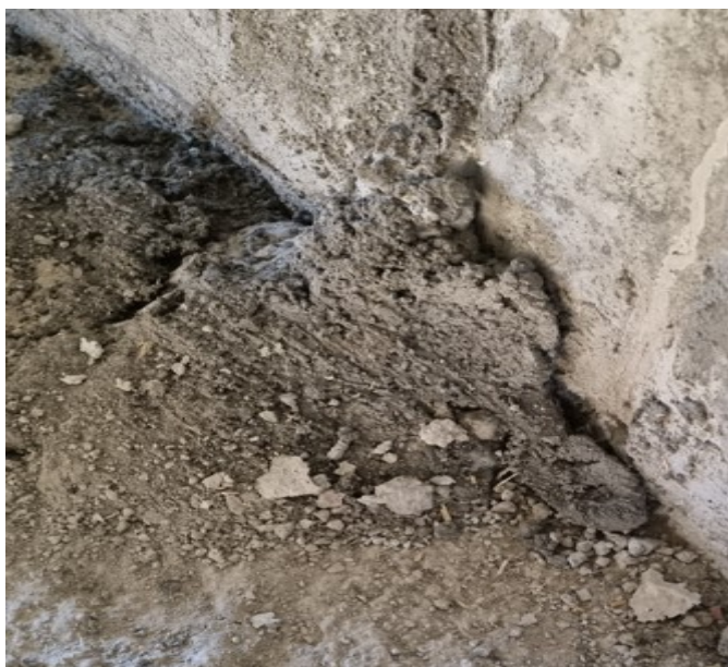
kuva 15. viimeistelemätön pystysaumauksen alapää
