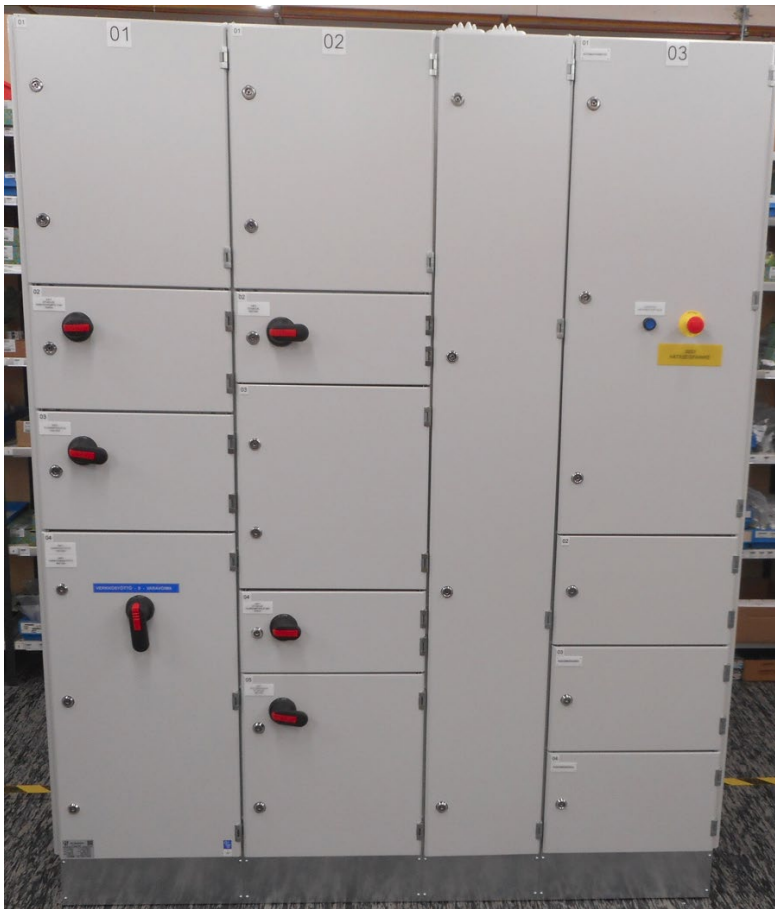
Kuva 2. Lämpölaitokselle valmistettu kennokeskus.
