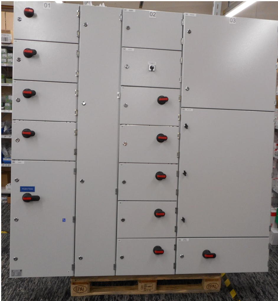
Kuva 1. Tarkistusta odottava kotelokeskus.
