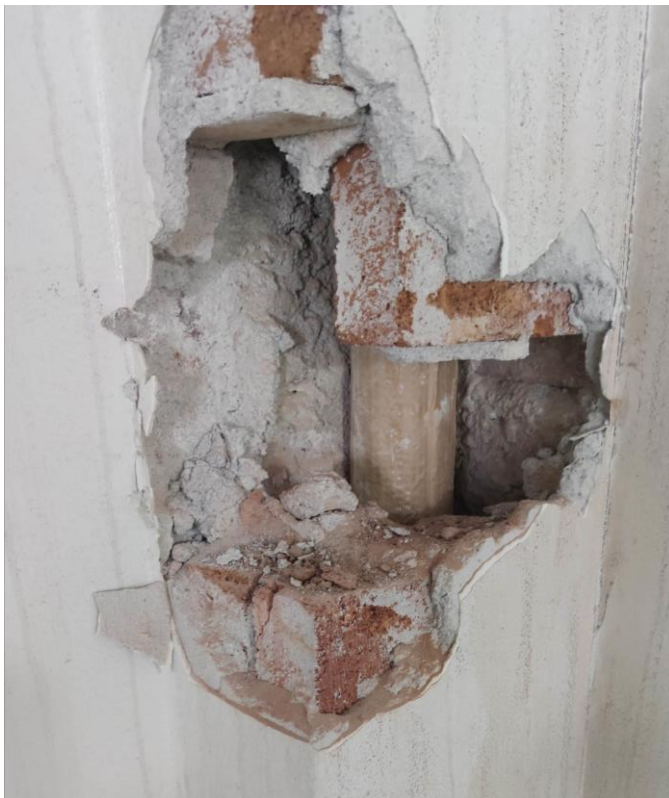
Kuva 5. Esimerkkikuva seinän sisällä kulkevasta putkesta, jonka päällä on asbestieriste ja pinnassa suojapahvi.
