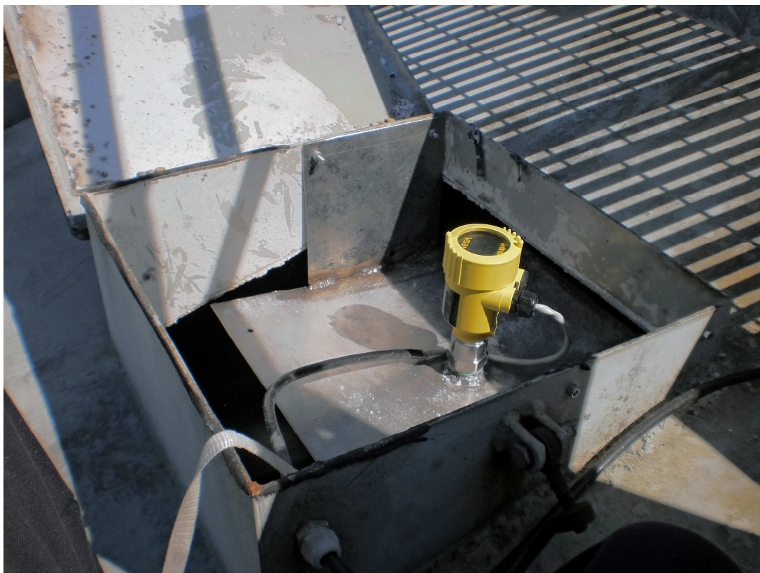
Kuva 5. Mikroaaltotutka asennettuna paikoillensa (Holmi, 2014)
