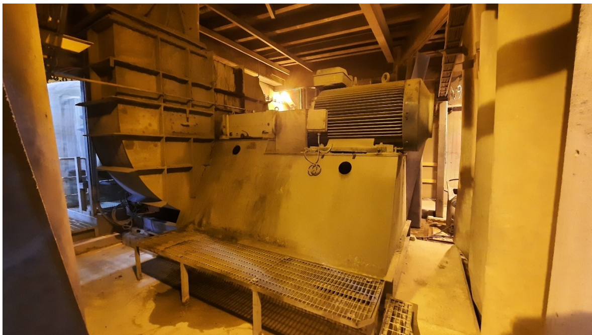
KUVA 22. Fosforihappotehtaan jätekaasupuhallin (Heikkinen 2022b)
