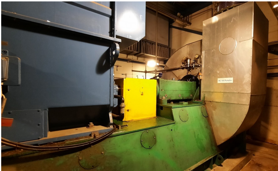
KUVA 18. Rikinpolttolaitoksen palamisilmapuhallin (Heikkinen 2022a)
