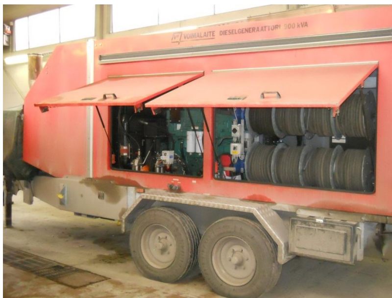
Kuva 2. Varavoimakoneena toimiva hinattava dieselgeneraattori.
