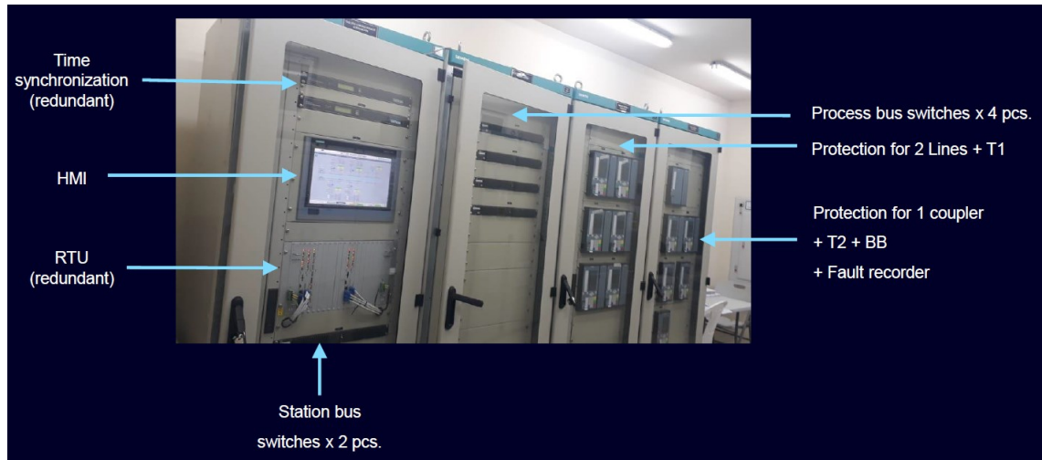
Kuva 29. Los Saucesin sähköasemalla saatiin uuden tekniikan myötä sijoitettua yhteen relekaappiin jopa kolmen kentän suojaruleistys (Siemens 2022)
