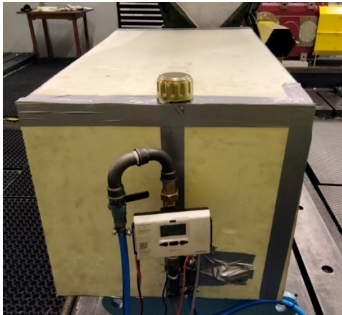
Kuva 9. Veden energiamittari asennettuna Cumpact-vaihteen päätyyn.
