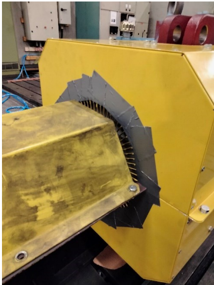
Kuva 19. Tuulettimen imua rajoitettu.
