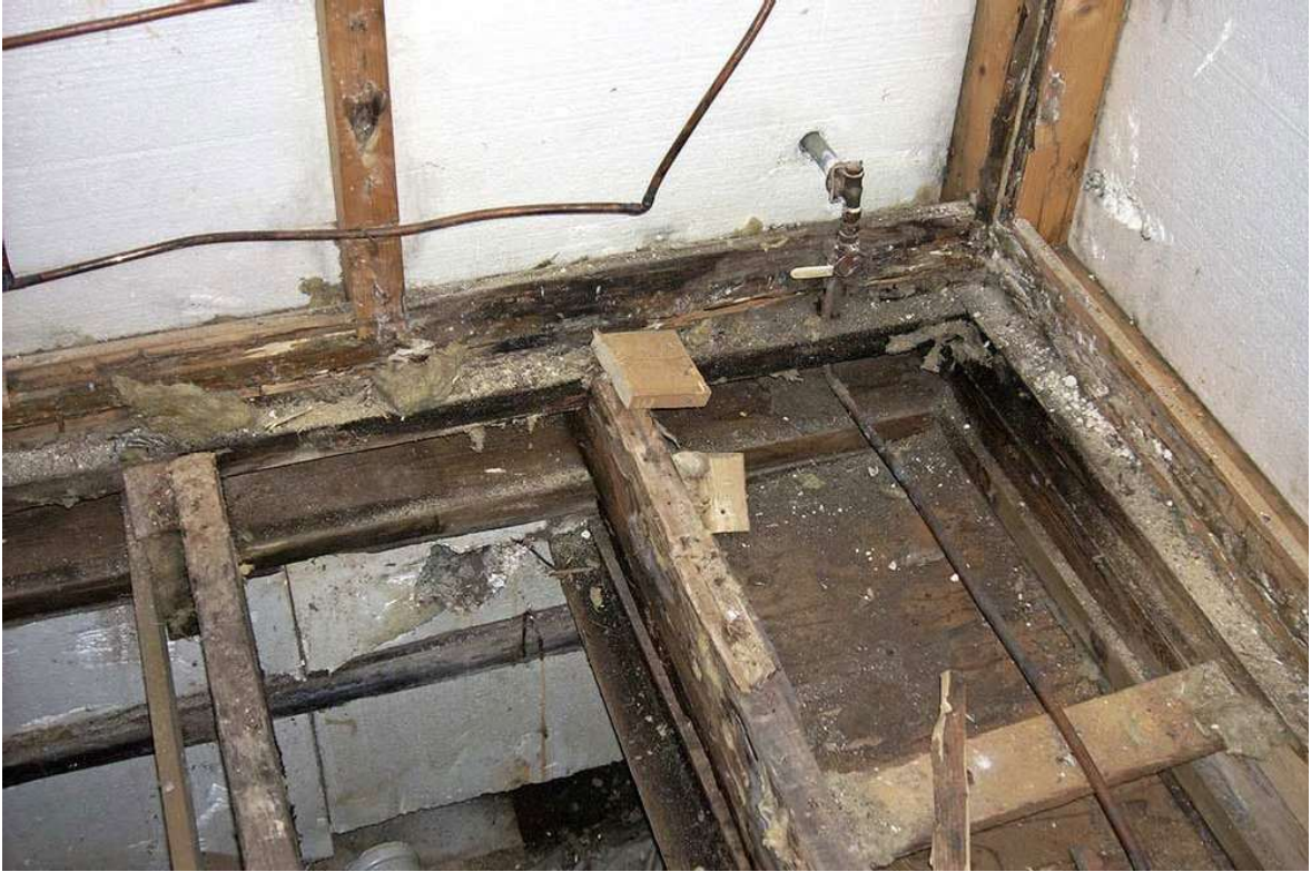
Kuva 4. Esimerkkinä mitä vesivauriot voivat rakenteille aiheuttaa (Suomela.)
