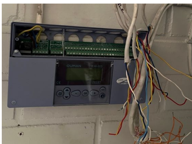
Kuva 8. Entinen IV-konetta ohjannut säädin irrotettuna.
