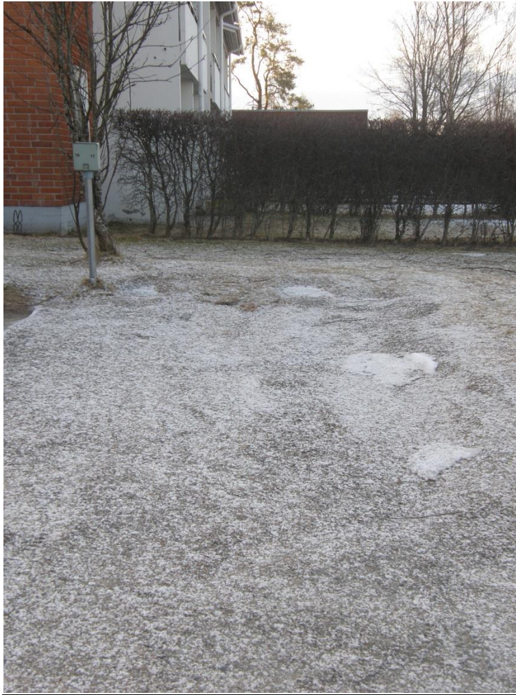
Kuva 1. Paikoitusalueen pinnoite on paikoin epätasainen ja alueen rajat ovat epäsiistit
