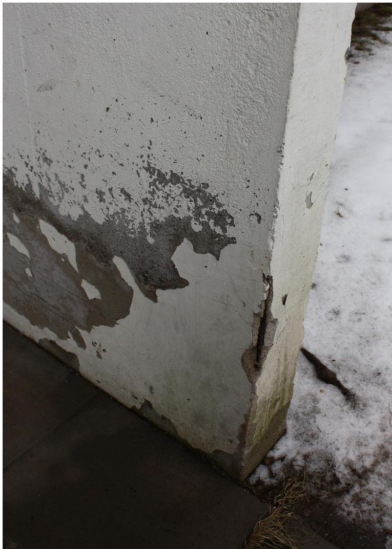
Kuva 9b. Terassien pieliseissä on havaittavissa kosteuden aiheuttamia vaurioita.
