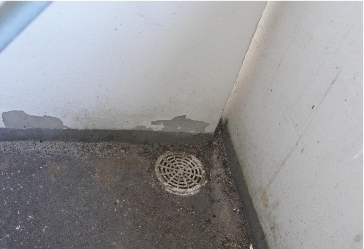
Kuva 8a. Parvekkeiden pieliseissä ja parvekelaatassa on paikoin kosteuden aiheuttamia pinnoitevaurioita
