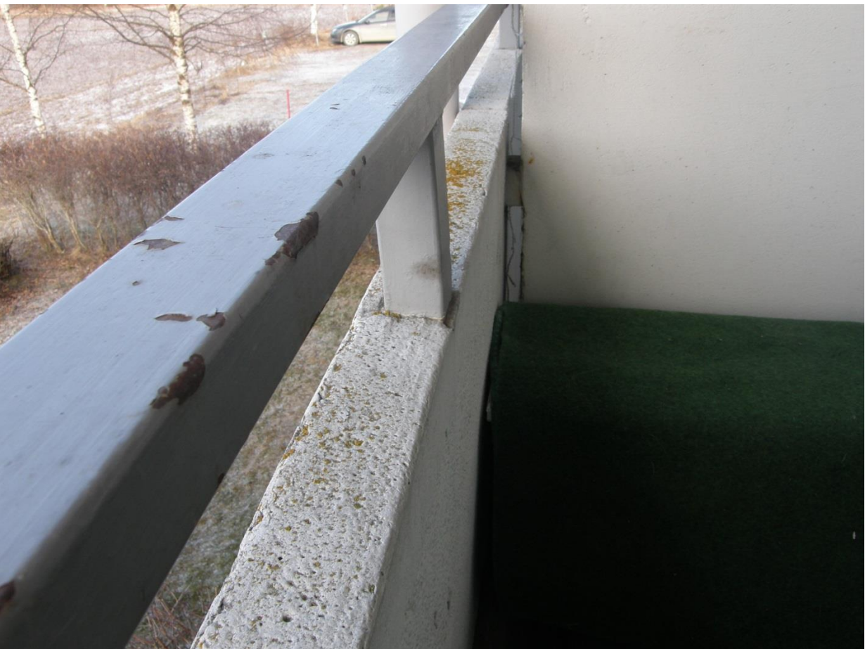
Kuva 8b. Parvekkekaiteissa on paikoin kosteuden aiheuttamia pinnoitevaurioita ja sammalta
