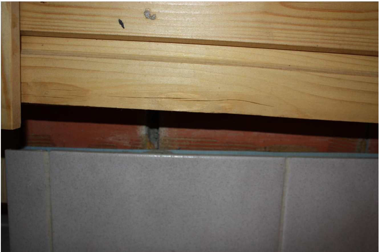
Kuva 13. Saunan vesieristeen liitos alumiinipaperiin on puutteellinen
