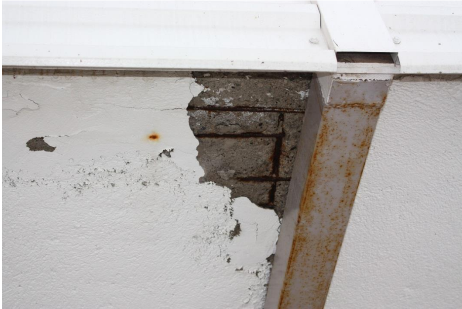
Kuva 10. Luhtikäytävän alaosaan on paikoin vaurioita
