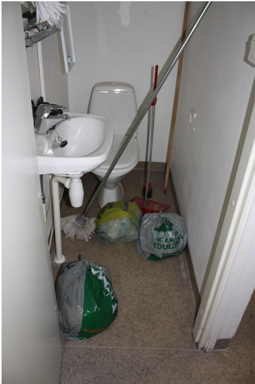
Kuva 11. Yleisten tilojen Wc:n yleisilme on epäsiisti
