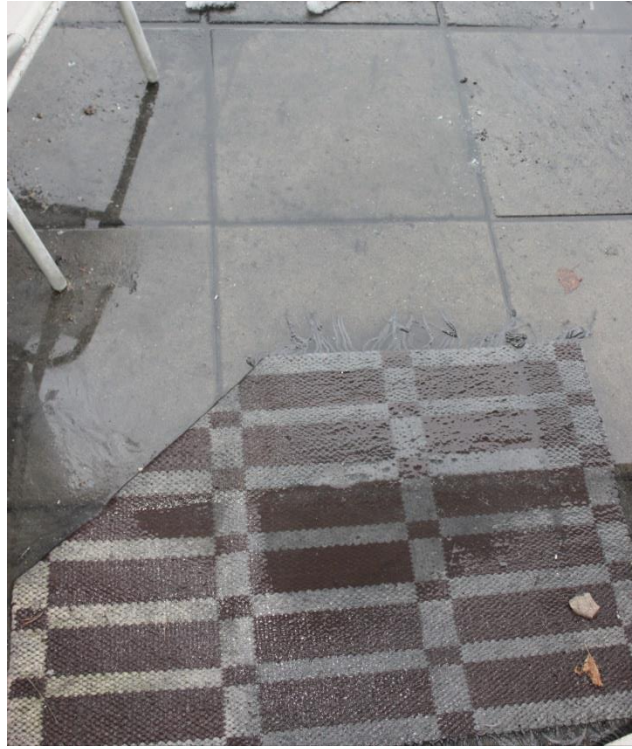
Kuva 9a. Terassien kaadot paikoin aiheuttavat rakennukselle kosteusrasitusta.
