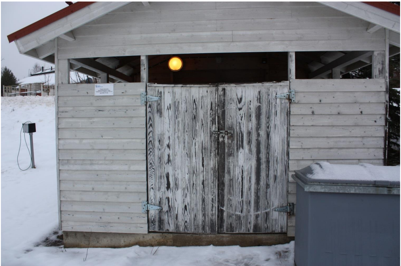
Kuva 8. Jätekatoksen ovet ovat hankalakäyttöiset ja ikkuna-aukkojen kautta elämillä on pääsy jätekatokseen.
