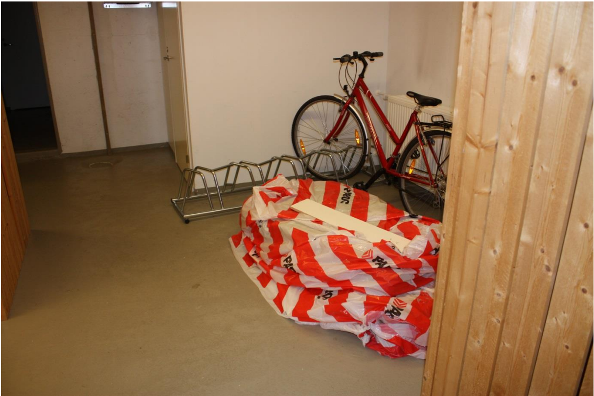
Kuva 14a. Väestönsuojassa olevassa häkkivarastotilassa on sinne kuulumatonta tavaraa.
