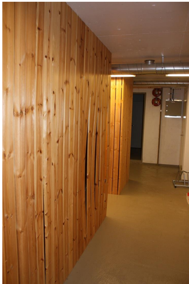
Kuva 14b. Häkkivaraston puiset seinät ovat vääntyilleet.
