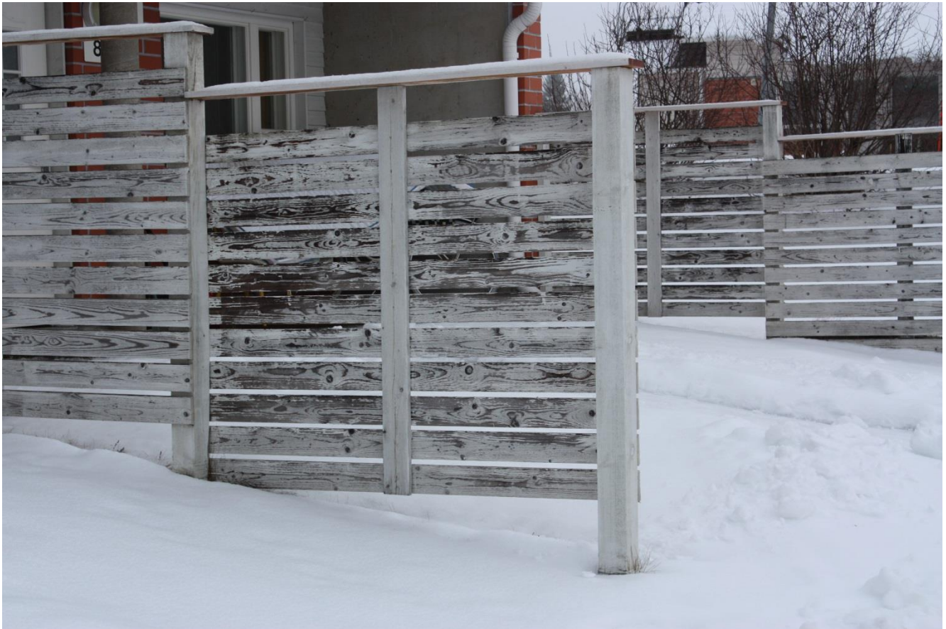
Kuva 9. Huoneistojen piha-alueita rajoittavien aitojen kunto on huono.
