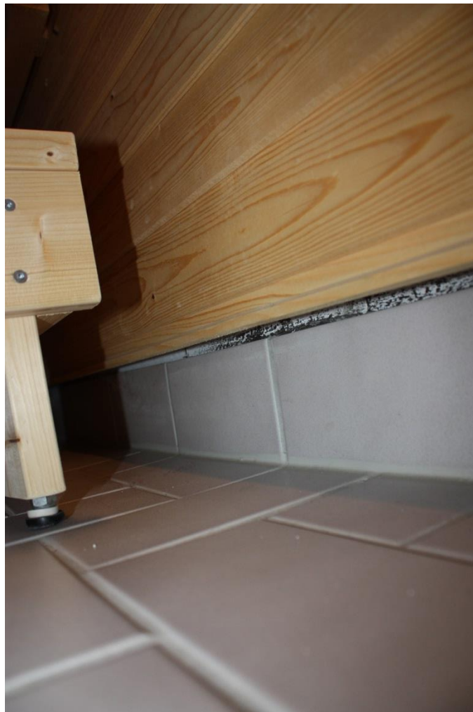
Kuva 15b. Huoneistosaunojen vedeneristeen ja alumiinipaperin liitos on vajaavainen.
