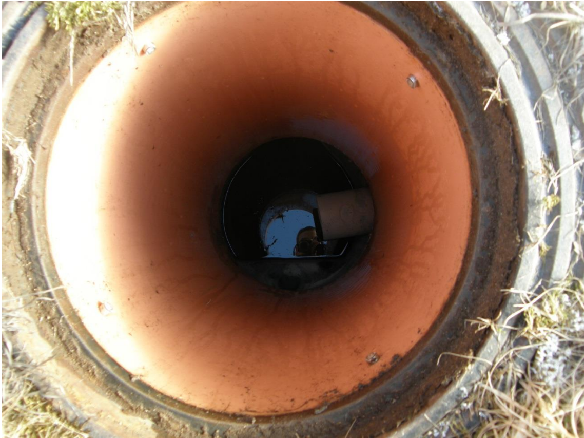
Kuva 1. Salaojien tarkistuskaivo (rakennus D). Vedenpinta on salaojien alapuolella.
