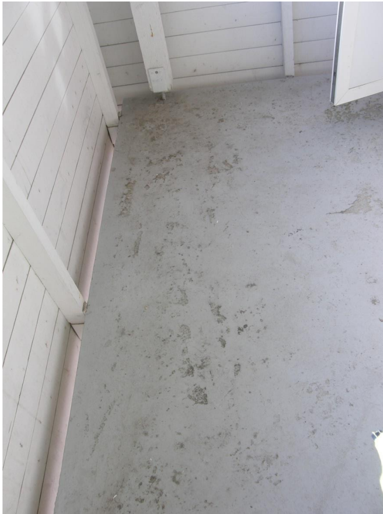
Kuva 13a. Parvekelaatassa on pinnoitevaurioita.
