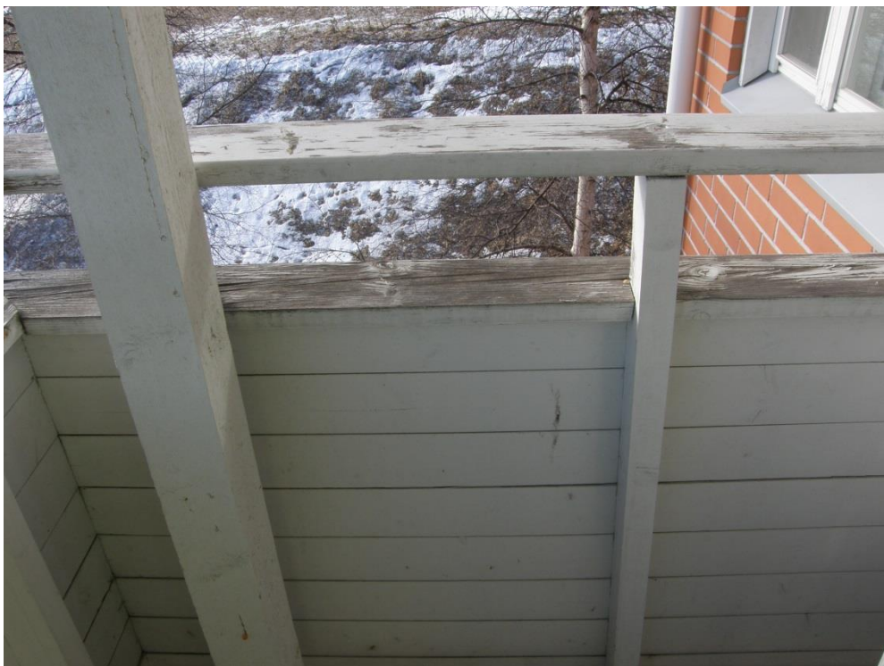
Kuva 13b. Parvekekaiteissa on pinnoite vaurioita ja osa parvekekaiteista myötää painosta.
