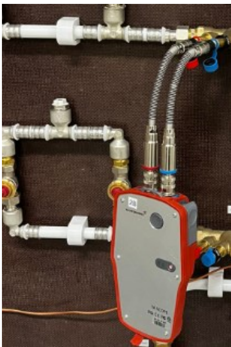
Kuva 24. TA-Scopen anturiyksikkö kytkettynä venttiiliin.
