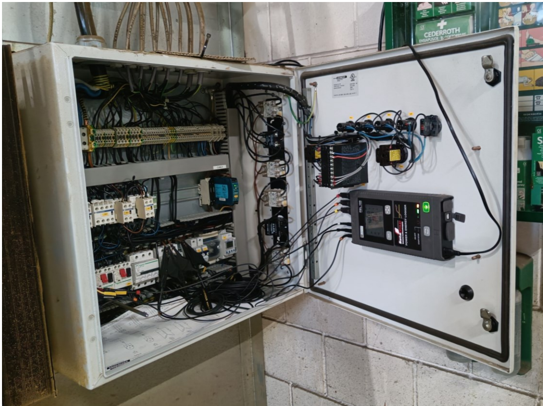
KUVA 5. Teho- ja energiatallennin kytkettynä uunin 14a sähkökaappiin.
