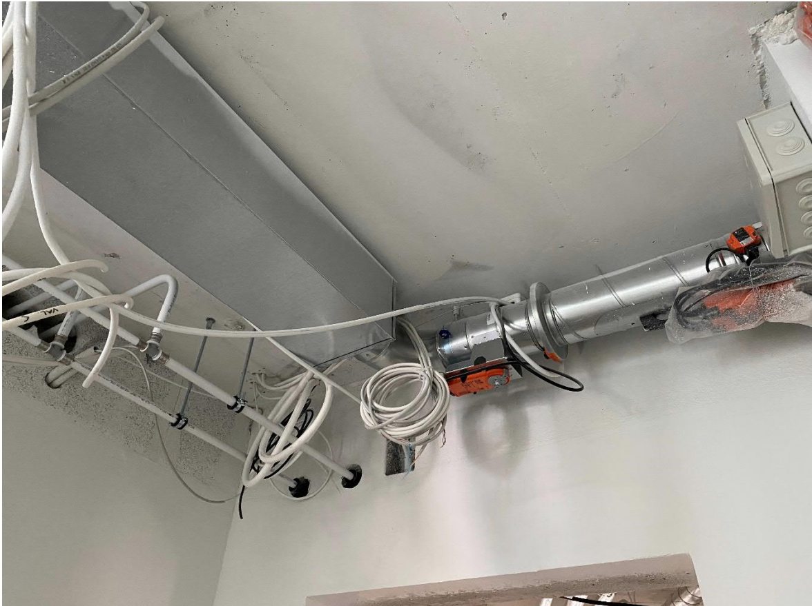
Kuva 5. Kohteen mallihuoneen LVI asennukset eteisen katossa
