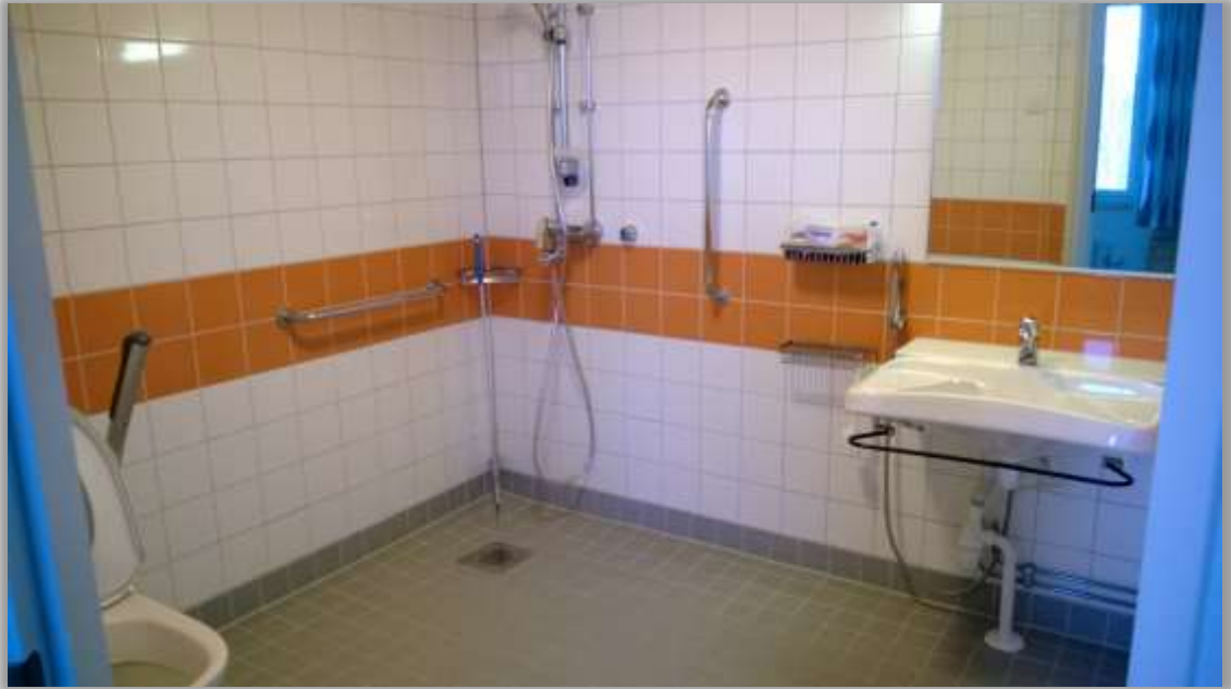
KUVA 23: Esteetön wc potilashuoneessa
