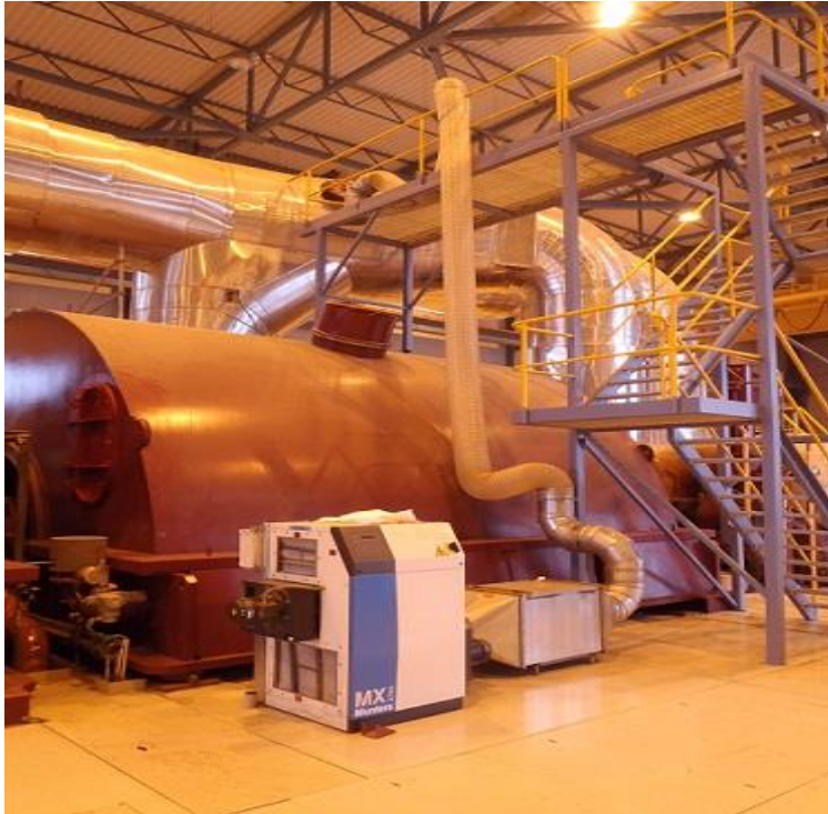
Kuva 15. Munters MX 2700 ilmankuivan vp- ja mp-turbiinin väliselle ylivirtausputkelle (Matias Kivelä)
