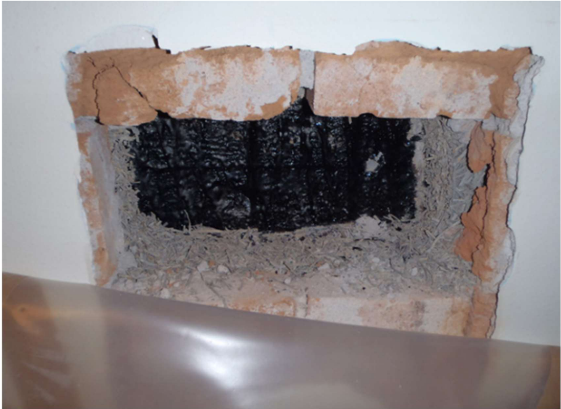
Kuva 4. PAH-yhdistepitoinen bitumisively sementtilastulevykerroksen takana. (RT 18-11245, 11)
