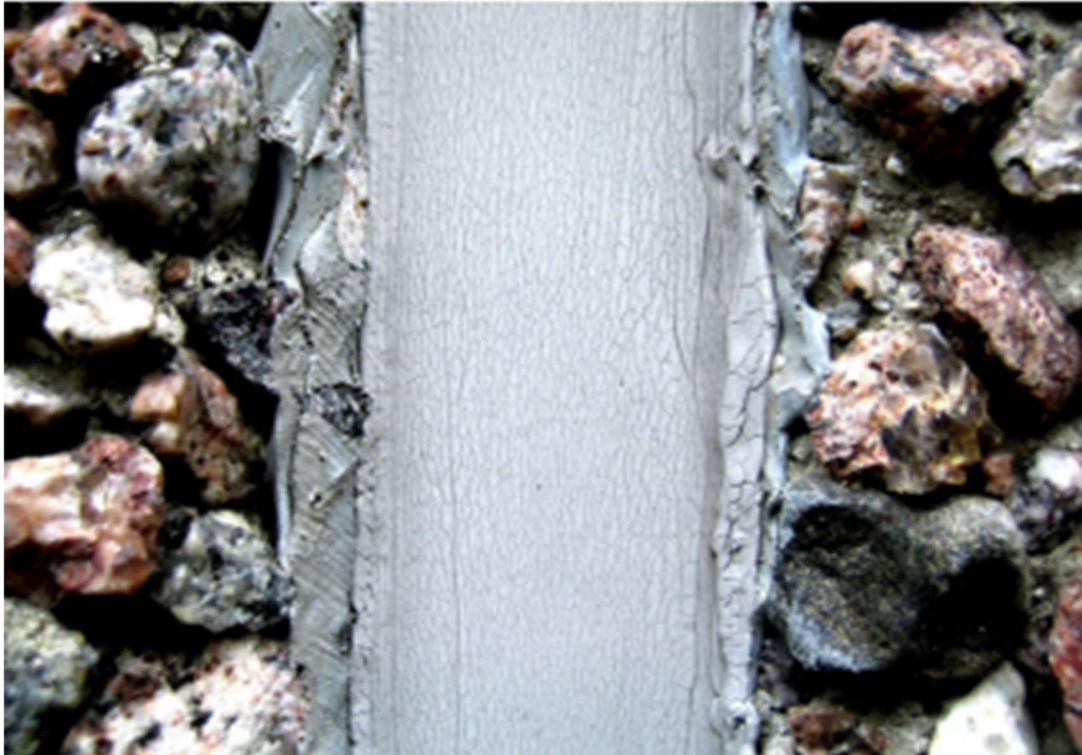
Kuva 5. Julkisivun uusi elastinen julkisivusauma, johon on imeytynyt vanhasta saumasta PCB-yhdisteitä (RT 18-11245, 12.)
