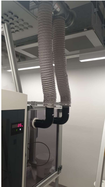
Kuva 10. Suojarakennelman tuloilmaputket liitettyinä ilmanvaihtoon. Ilmanvaihtokanavien sisällä on vapaavirtaussuodattimet.
