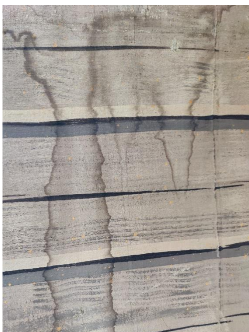
Kuva 24. Kulissin 3 yläosan kosteusvaurio (Laasasenaho 2022)
